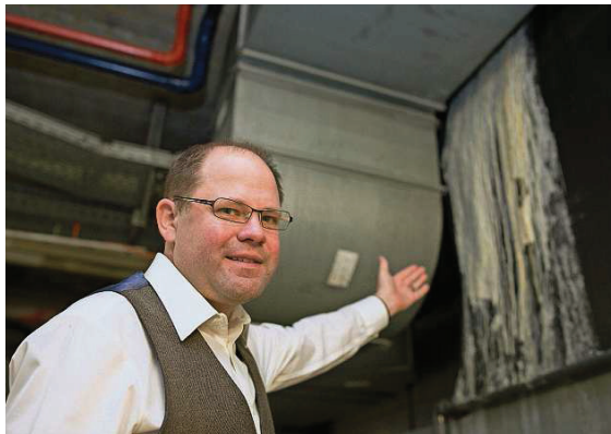
Der Handlungsbedarf ist gross: Adrian Hager zeigt, wo die Lintharena dringend saniert werden muss.
