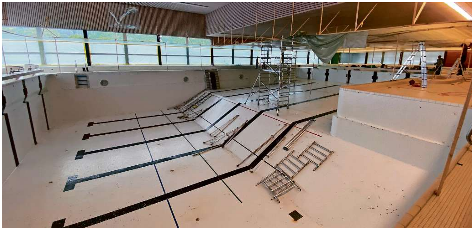
Die Gerüste stehen schon: Das Hallenbad der Lintharena SGU ist am stärksten von den Sanierungsarbeiten betroffen.
